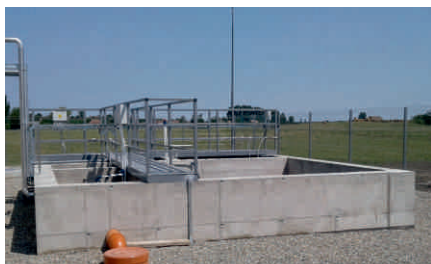
Stații de epurare
